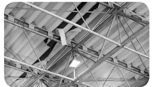
修繕予定の体育館天井(土睦小)
